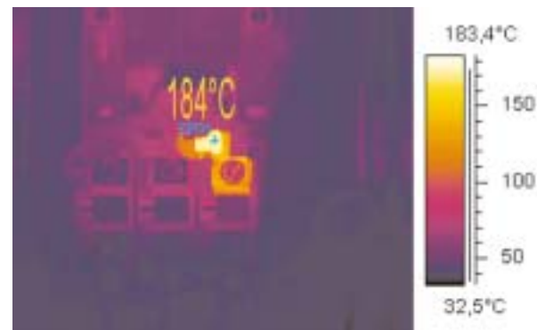
Kleine Ursache - große Wirkung: Kurzschluss (auf der Infrarotaufnahme ist die Hitzeentwicklung deutlich sichtbar)
